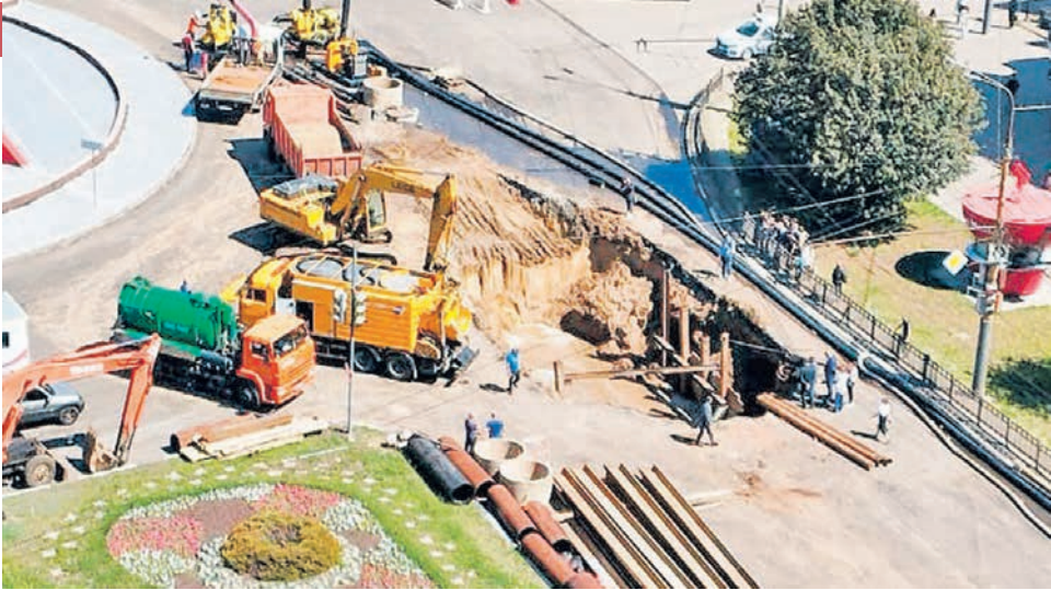
Из-за провала грунта участок Московского проспекта перекрыли для движения транспорта на несколько дней
