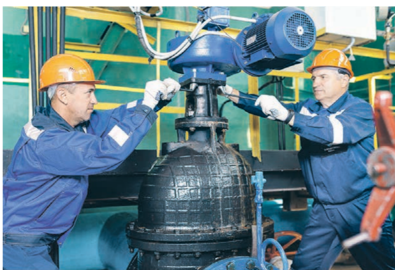
Объём инвестиций в водоканальное хозяйство Воронежа будет увеличиваться
